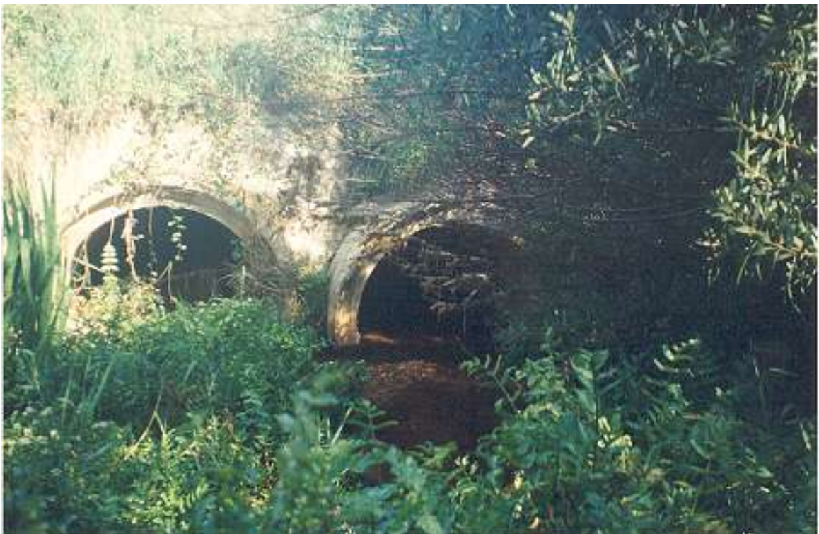
Figura C2 – Aqueduto duplo de secção circular. Entrada com forte assoreamento e vegetação.
