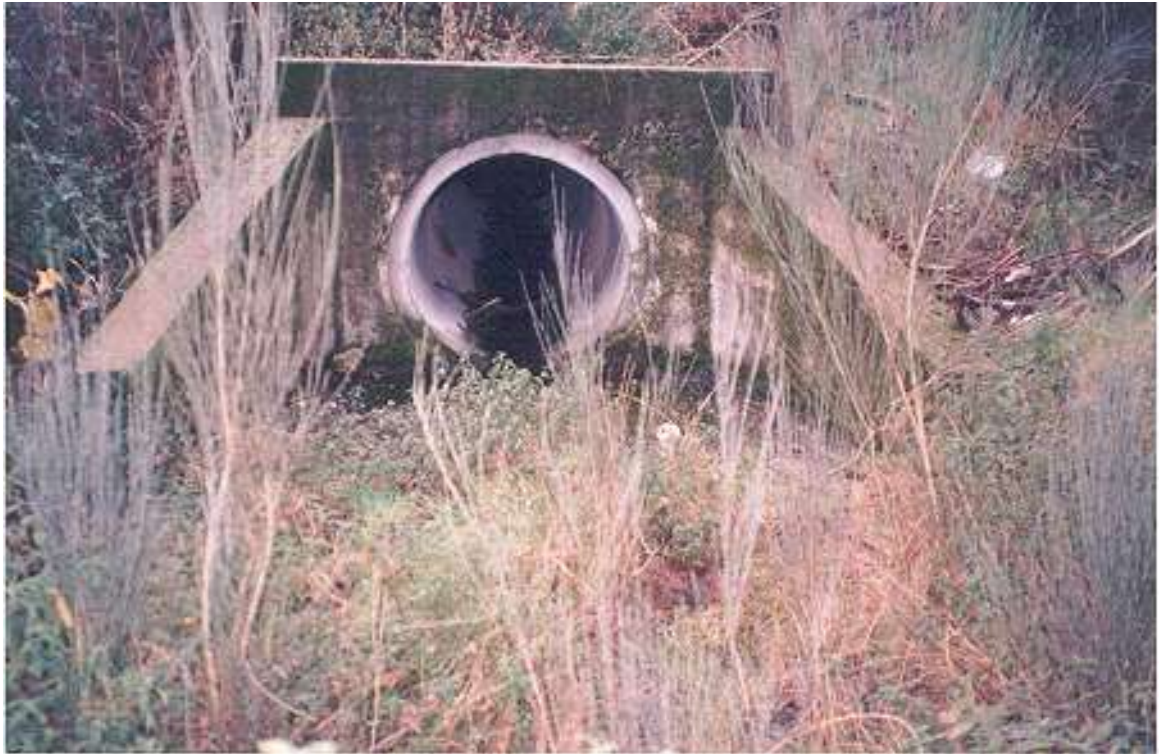
Figura C1 – Aqueduto de secção circular e estrutura de saída com muros de ala.
