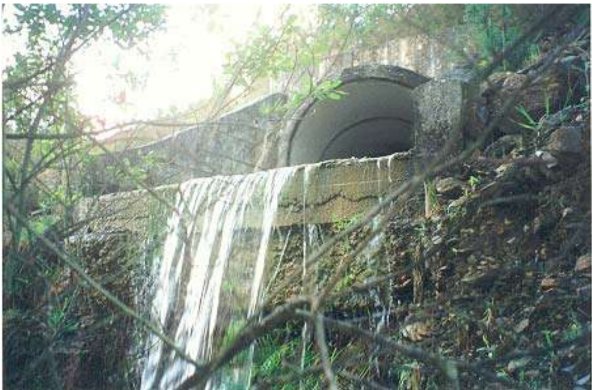
Figura C14 – Efeitos da ausência de dissipador de energia num aqueduto de secção circular.
