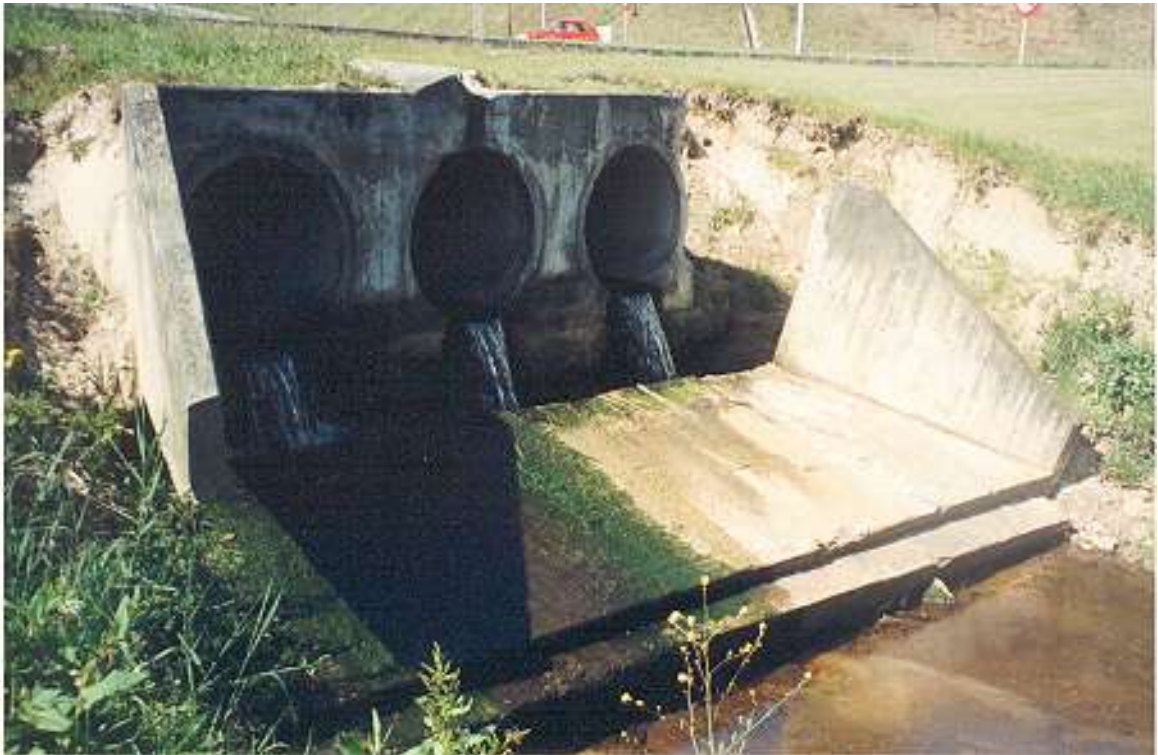
Figura C13 – Efeitos da ausência de dissipador de energia adequado num aqueduto de secção circular triplo.
